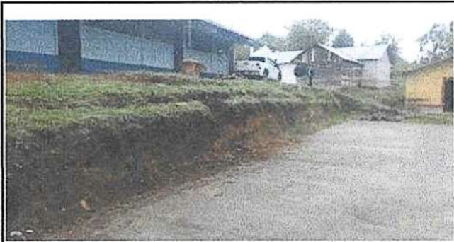
Foto 3: se observa lo peligroso de la altura del talud y de los graderillos y la necesidad de la rehabilitación de barandales.
