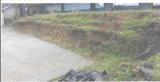
Foto 1: Se observa la necesidad del mantenimiento de la tierra o del talud, para ello hay necesidad de la rehabilitación de muro de contención
