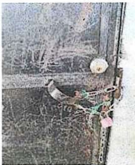
Foto 5: Se observa el deterioro de la chapa de la puerta de las aulas y de la dirección
