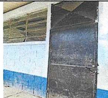
Foto 6: se observa la pérdida del color de la puerta de las tres aulas y de la dirección del establecimiento
